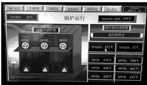
图3 电蓄热热风炉控制界面
