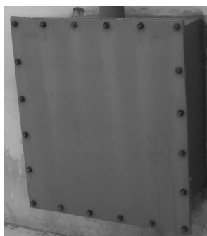
图1 螺栓紧固的方形通风口
