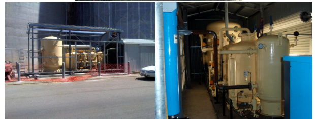
图 3 在 CBH Albany 谷物出口码头 (35°1'50.90"S 117°53'10.54"E) 安装了一台 350 m 3 /h 变压吸附 (PSA) 制氮机, 制氮机与一排 10×10 000 t 的混凝土仓相连。
